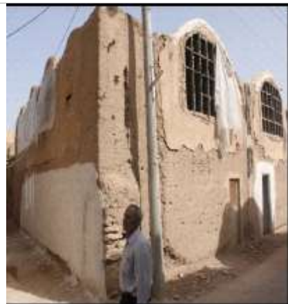
نمای ظاهری کارگاه قبل از مرمت
